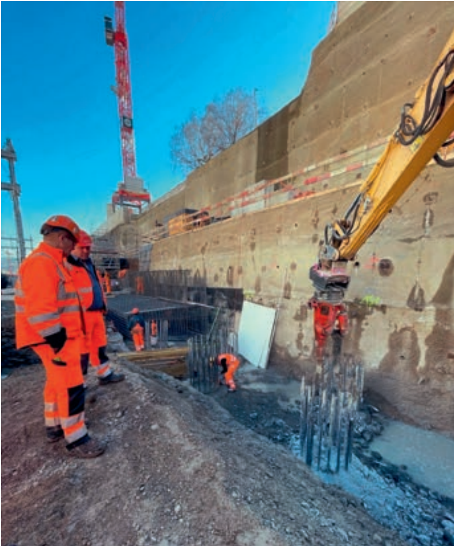
Stefan Lang (links), Bauführer bei Implenia, schaut sich das Ergebnis des Brextor zusammen mit Roland Waser, Technischer Leiter BRC, an.
